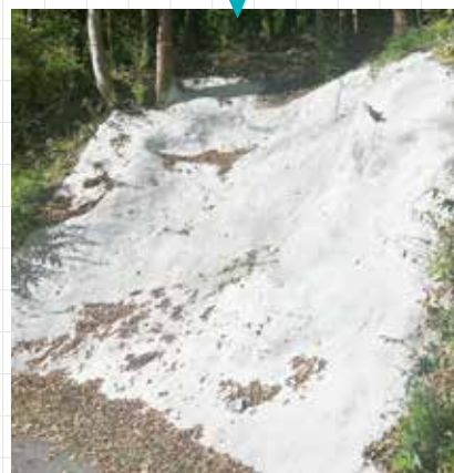
モルタル吹付面経過観察 (5 か月後)
