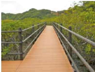
【事例5】床板：Kankyo-wood II 構造材：鋼材+C-LESS基礎 転落防止柵：プラ擬木
